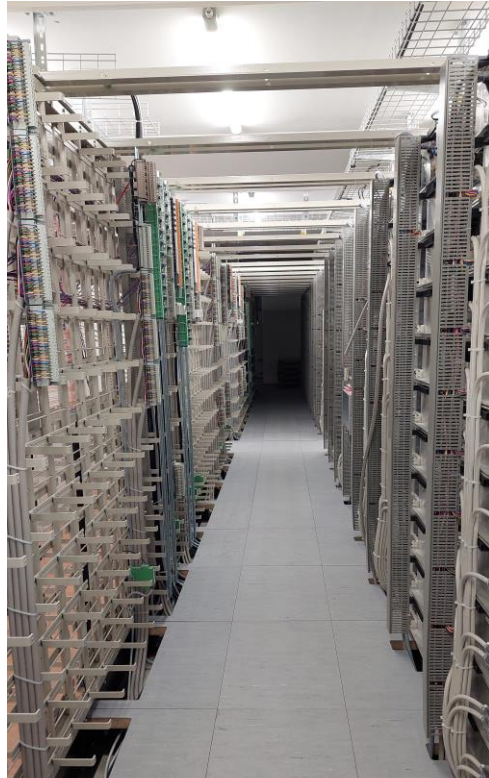
Gestelle für LST* Komponenten mit Verkabelung
