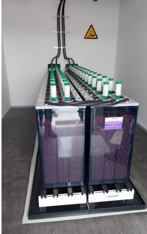
Batterie für die Notüberbrückung der Stromversorgung
